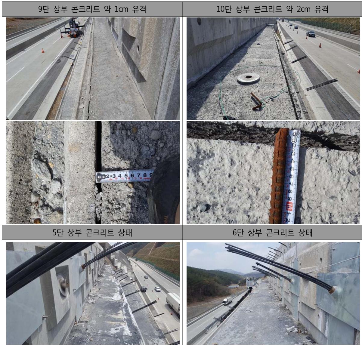
그림 5.2 절토부 옹벽 상부콘크리트 상태(2018년 4월)
